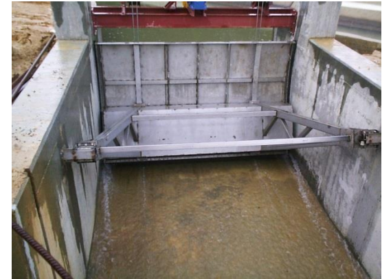
Compuertas Taintor Balsa de Aljaraque
