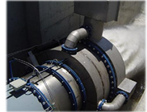
Válvula tipo Howell - Bunger de 1.500 mm de diámetro en la presa de Sierra Brava (Confederación Hidrográfica del Guadiana)
