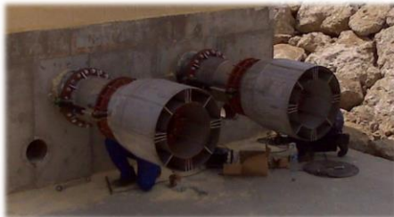
Válvulas tipo Howell - Bunger de 450 mm de diámetro en la balsa de El Rosario (Confederación Hidrográfica del Guadalquivir)
