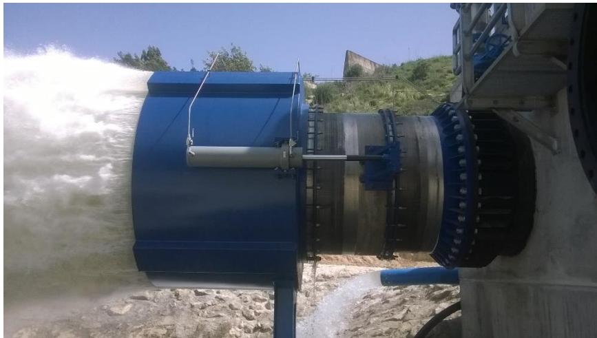
Válvulas tipo Howell - Bungler de 1.600 mm de diámetro para el desagüe de fondo de la presa de Guadalacacín (Junta de Andalucía)
