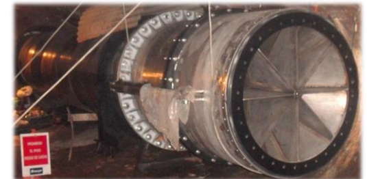
Montaje de válvula tipo Howell - Bunger de 1.200 mm de diámetro en el túnel del desagüe intermedio de la presa de Tranco de Beas (Confederación Hidrográfica del Guadalquivir)
