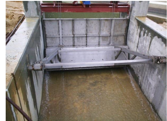
Compuertas Taintor Balsa de Aljaraque
