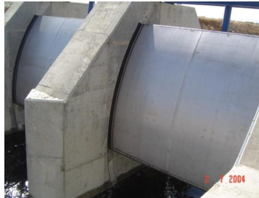
Compuertas Taintor Canal de Orellana
