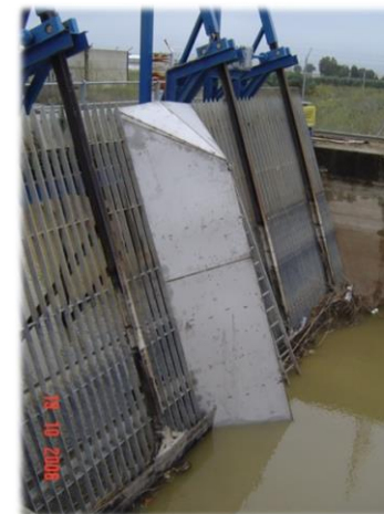
Limpiarrejas lineales en el canal del Bajo Guadalquivir. Confederación Hidrográfica del Guadalquivir.
