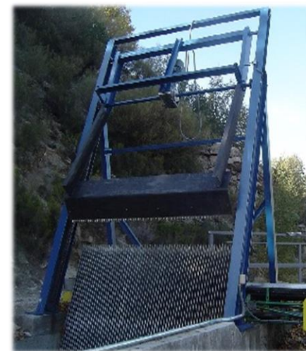
Limpiarrejas basculante en el canal de alimentación de la presa de Navamuño. Confederación Hidrográfica del Tajo.
