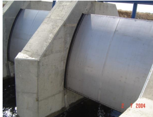
Compuertas Taintor Canal de Orellana
