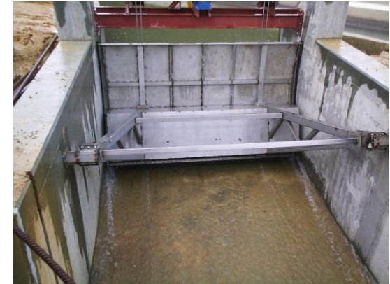
Compuertas Taintor Balsa de Aljaraque
